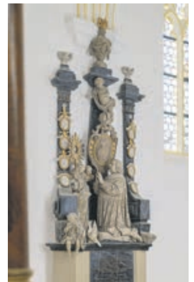
Die Epitaphe weisen diverse Fehlstellen und Risse auf, die nun beseitigt werden.
