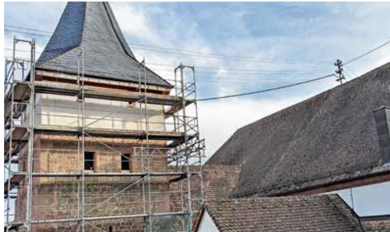
Der Zahn der Zeit hatte am Ranschbacher Kirchturm genagt, eine Renovierung mit verschiedenen Maßnahmen war nötig geworden.
