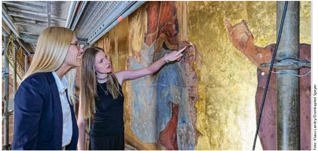
Christin Sauer und Anne Lackner beim Betrachten des komplexen Schadensbildes am Wandgemälde von Johann Baptist Schraudolph in der Vorhalle des Speyerer Doms.
